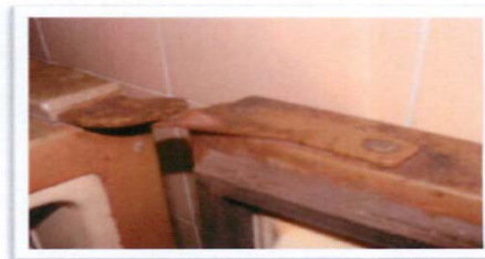
7. PORTA: Pino e dobradiça em péssimo estado
